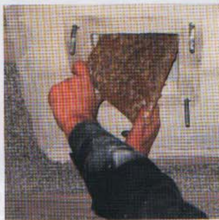
Brandgefahr Brennbare Bauteile im Lüftungsschacht
