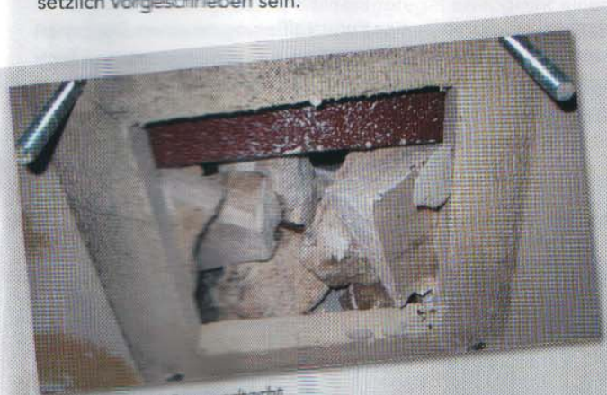
Bauschutt im Lüftungsschacht
