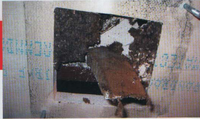
Schaumstoff im Lüftungsschacht – Nährboden für Bakterien und Pilze
